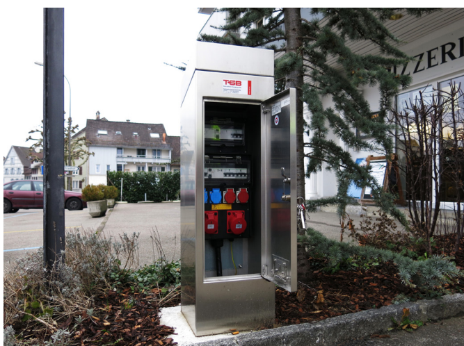
Colonnina d'energia elettrica QUADRO
