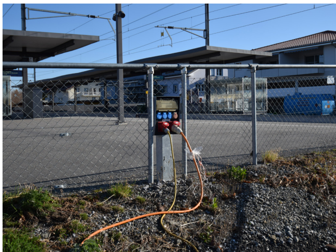
Quadro distribuzione presso la stazione Oberriet
