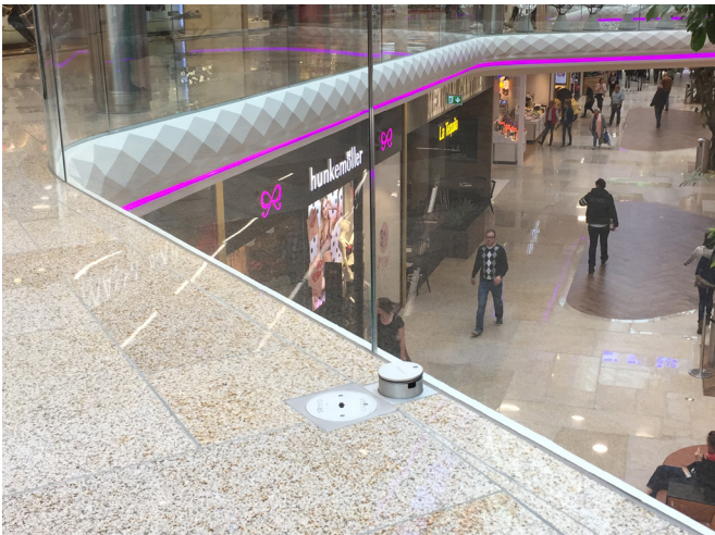
Presca da pavimento Fonte e Masso, Centro commerciale Plus City
